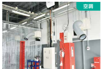
各リフトには大きなダクトが設けられ、空調や温度の管理もばっちり
